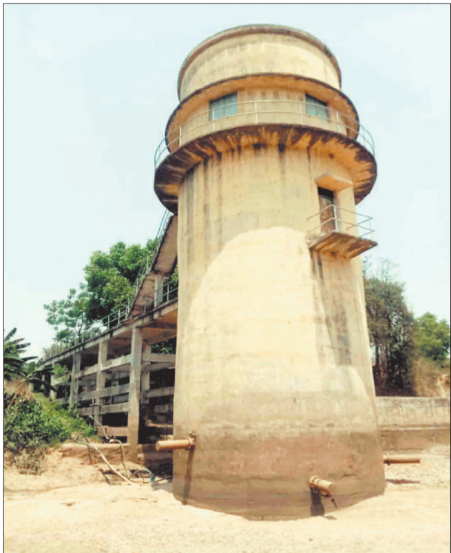
चनान नदी पर बना वाटर ट्रीटमेंट प्लांट।
